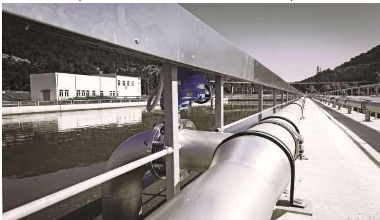
Пречиствателна станция за отпадъчни води Габрово
